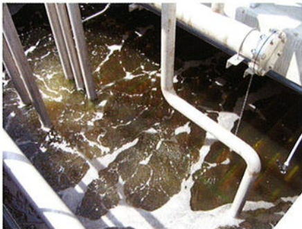
最終処分場 浸出水処理施設
